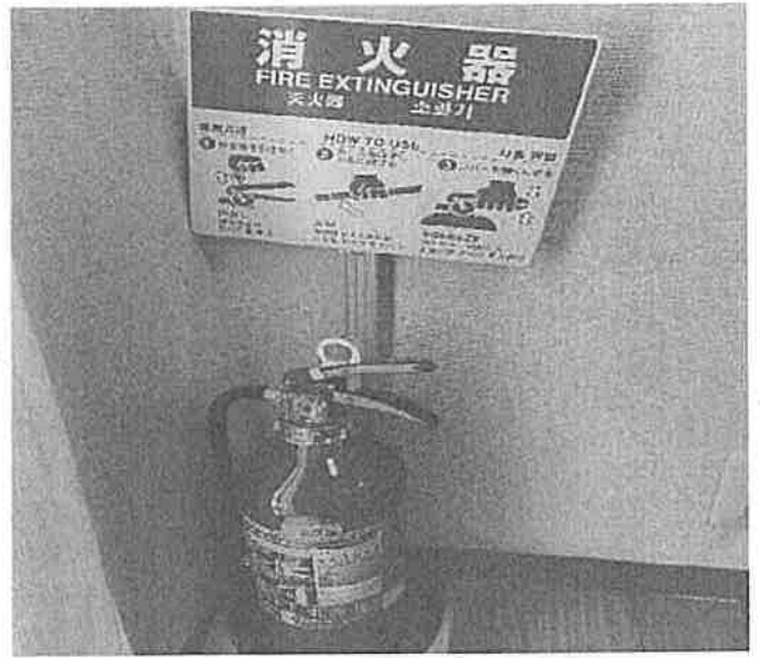
⑱ 食堂兼機能訓練室 消火器
