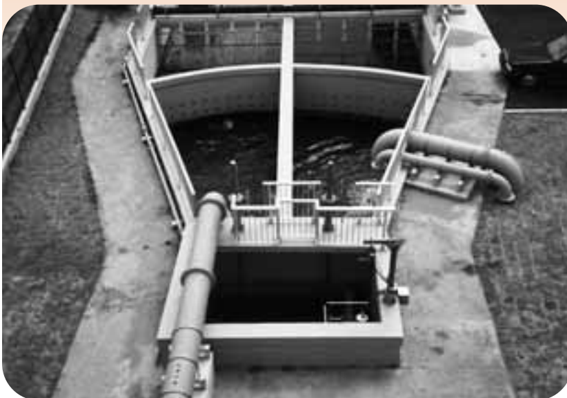
処理水槽(左)と原水槽(右)
