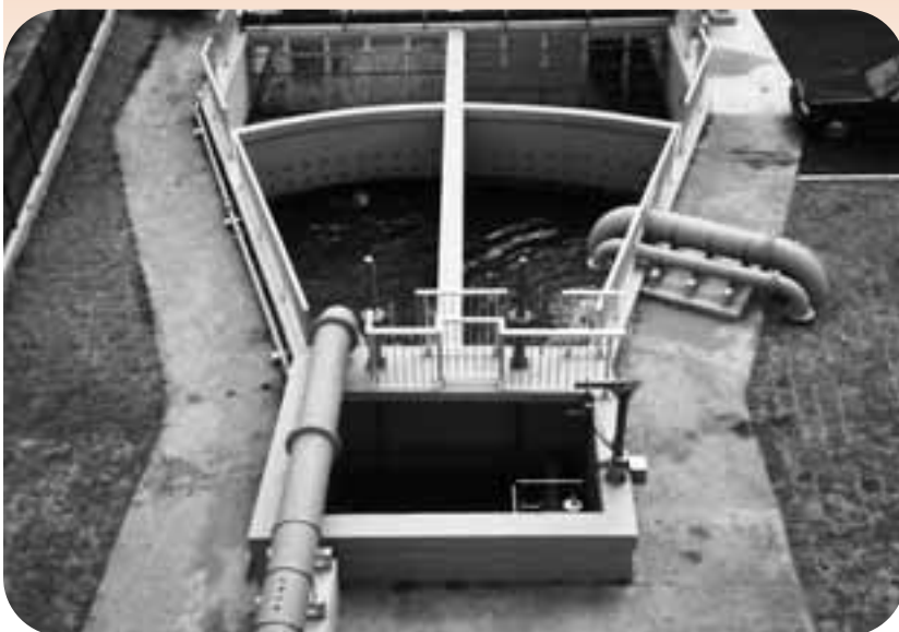
処理水槽(左)と原水槽(右)
