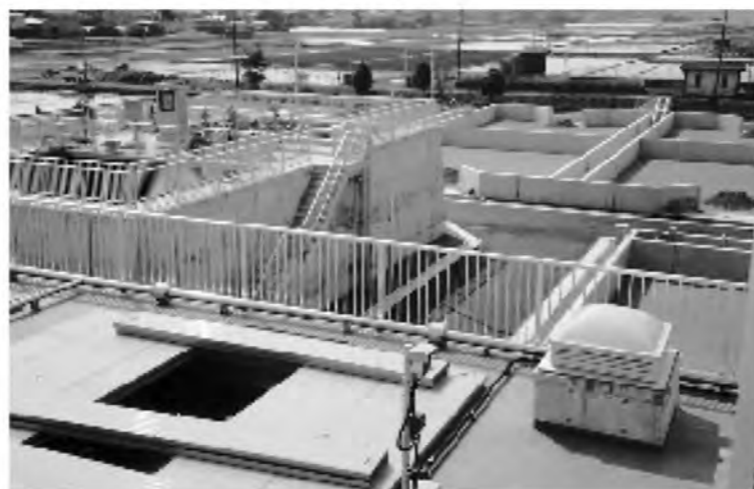
(手前：生物活性炭処理槽 左奥：回収槽)
