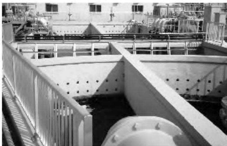
(左：処理水槽 右：原水槽)
