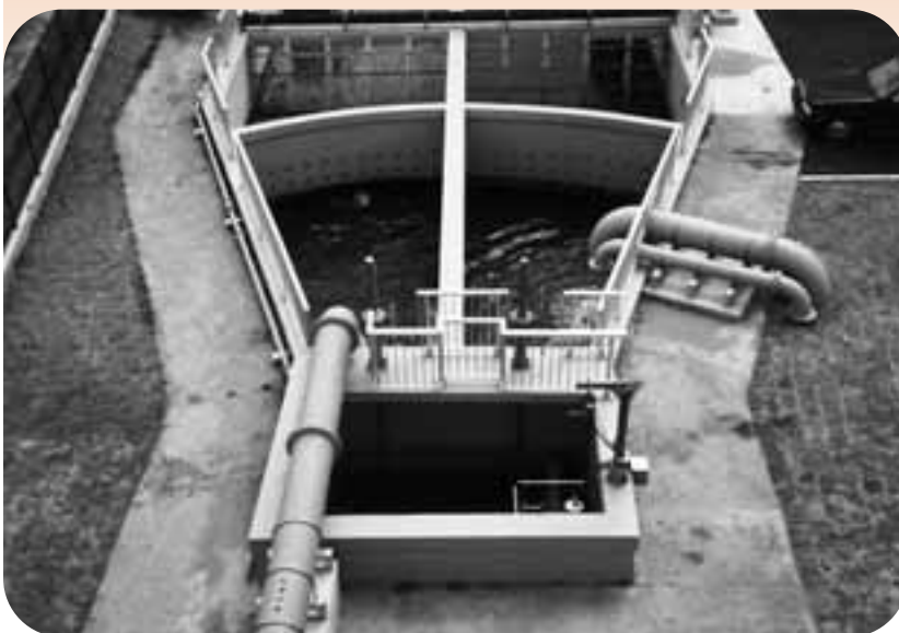
処理水槽(左)と原水槽(右)
