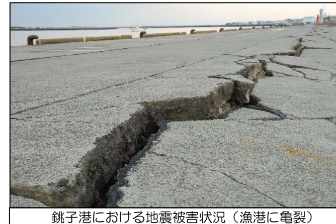
銚子港における地震被害状況(漁港に亀裂)
