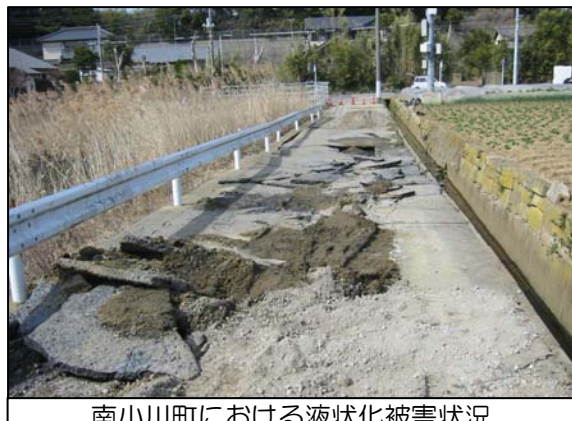
南小川町における液状化被害状況
