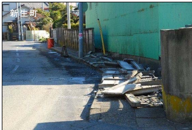
3月12日 地震によるブロック塀の倒壊
