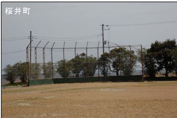
4月16日 野球場のバックネット破損
