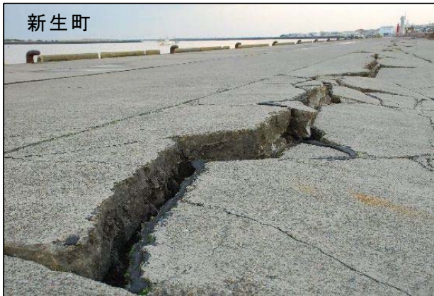
3月11日17:18 地震により港内に亀裂
