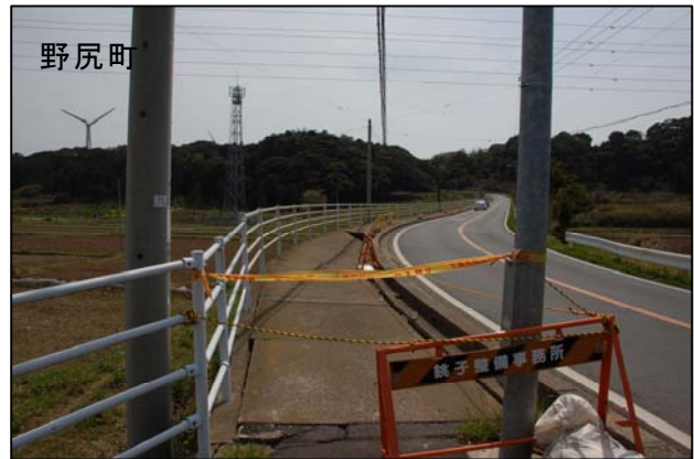
4月16日 歩道の破損による通行禁止
