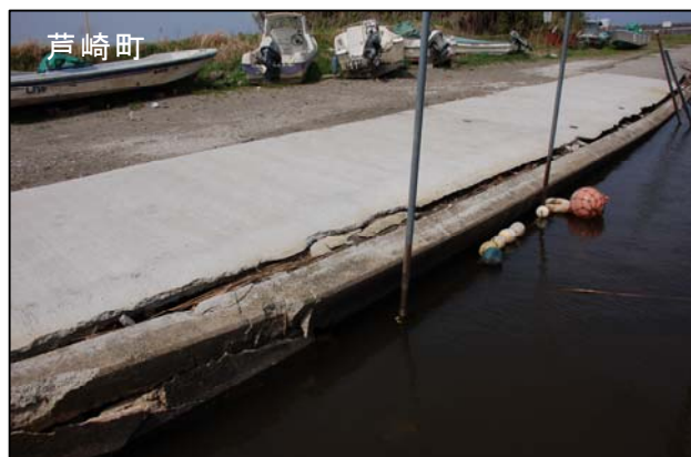
4月16日 船入場の護岸の破損状況
