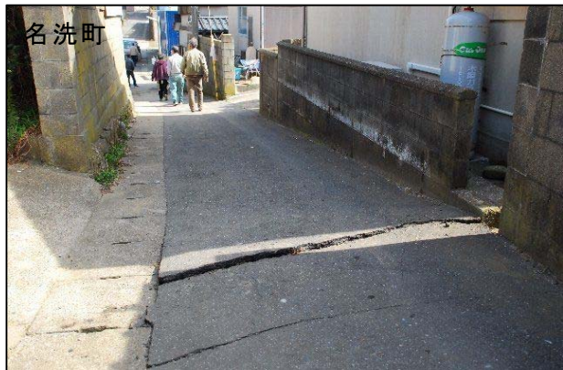
3月12日 地震による道路の亀裂
