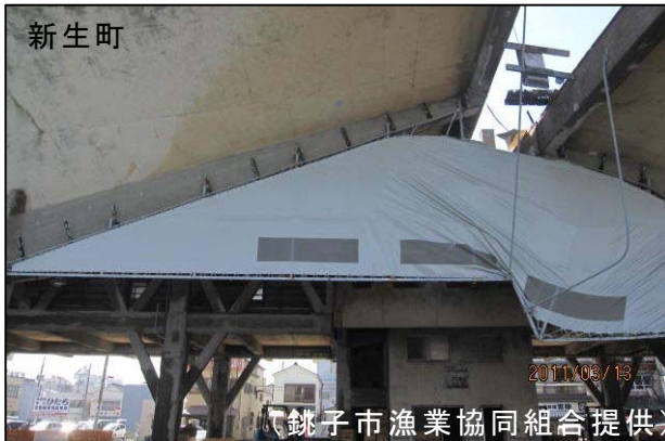
3月13日地震で第一卸売市場の雨よけ破損
