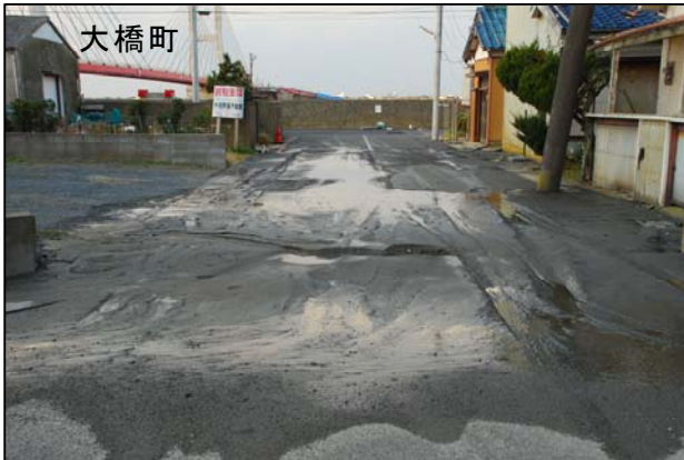
3月11日 利根川堤防付近の道路の液状化
