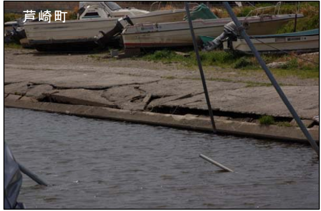
4月16日 船入場の護岸の破損状況
