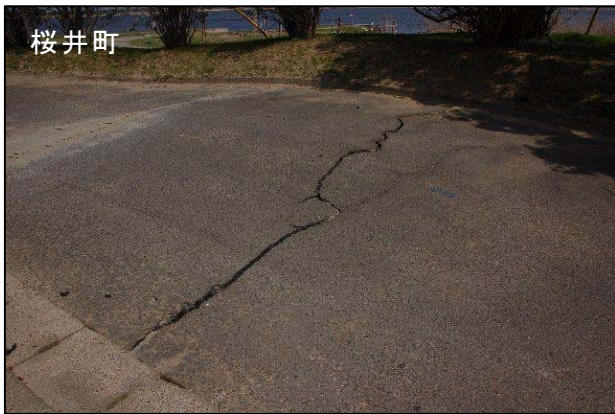
4月16日 地震による公園内の道路に亀裂
