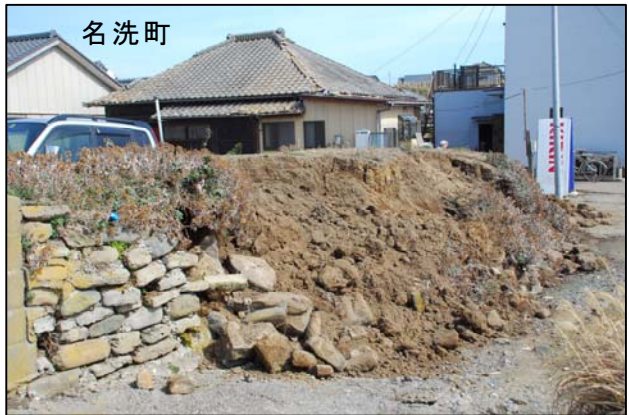
3月12日 地震による法面崩落
