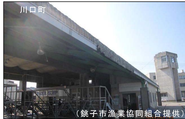
3月13日 地震による屋根の崩壊
