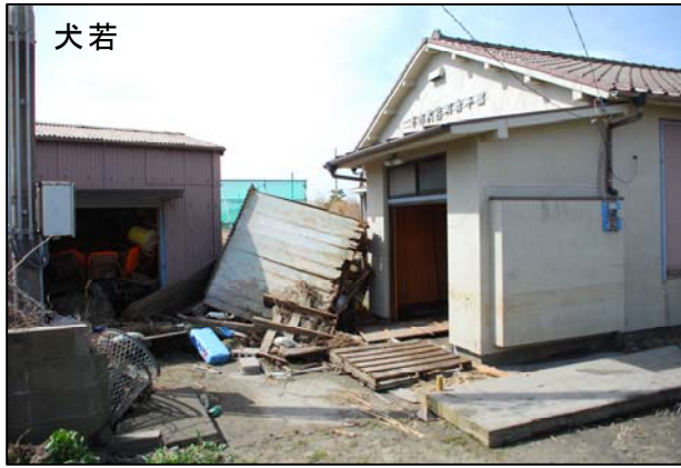
3月12日 津波により犬若青年館破損
