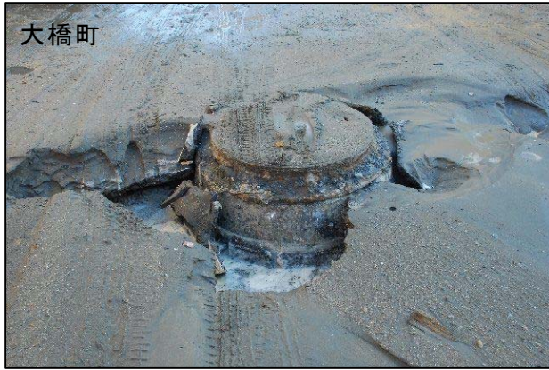
3月11日 液状化によるマンホールの浮上
