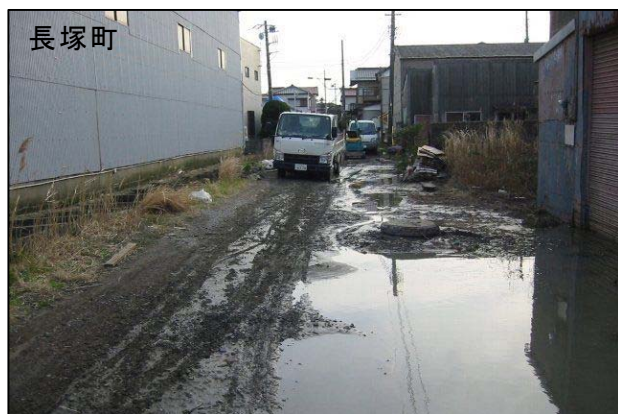
3月12日 液状化によるマンホールの浮上
