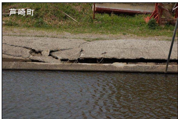
4月16日 船入場の護岸の破損状況
