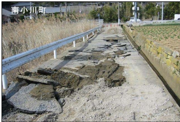
3月12日 地震による液状化で道路の破損
