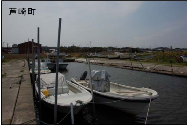
4月16日 地震による船入場の護岸破損
