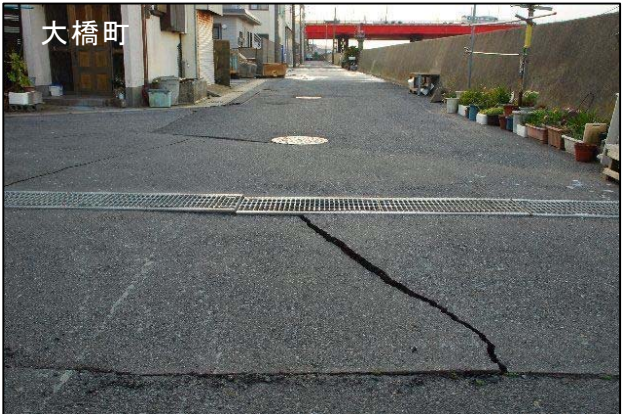
3月11日 利根川堤防付近の道路に亀裂
