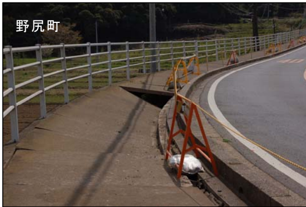
4月16日 地震による歩道の破損
