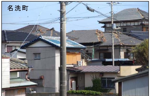
3月12日 地震による民家の屋根崩落
