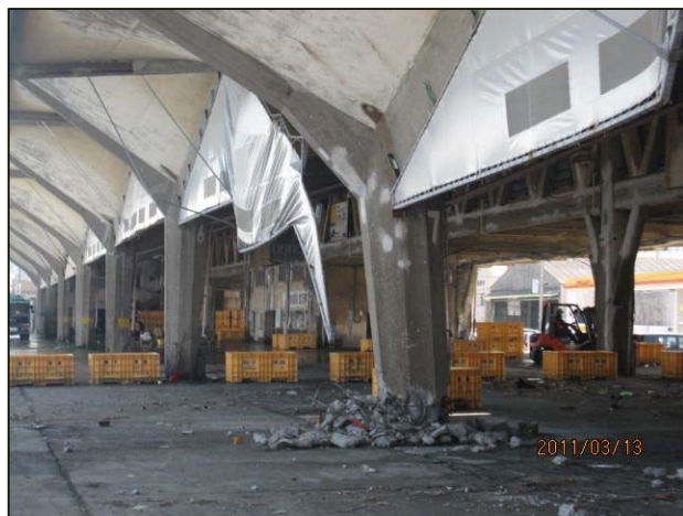
3月13日 第一卸売市場の柱の崩壊 (銚子市漁業協同組合提供)
