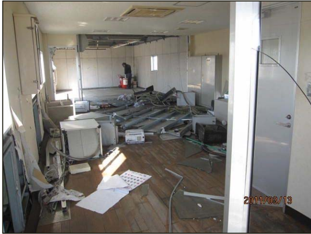
3月13日 外川支所外川給油所の事務所内被害 (銚子市漁業協同組合提供)
